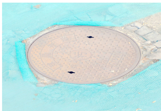
项目内下水检修井
