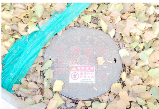
项目内上水检修井
