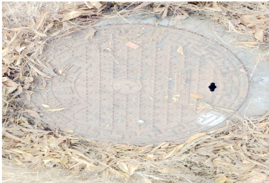
项目内热力检修井
