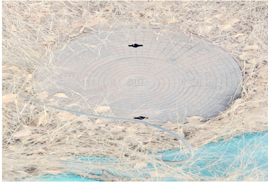
项目内通信检修井
