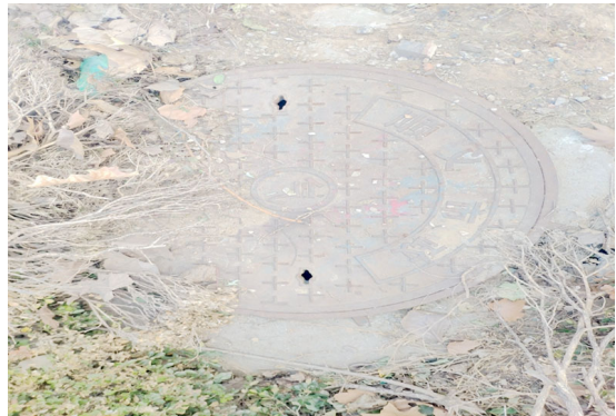
项目内燃气检修井
