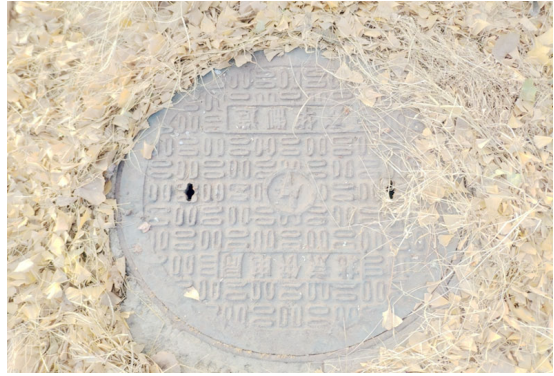
项目内电力检修井
