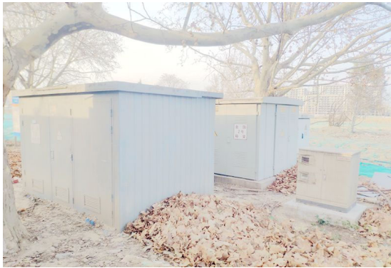
项目内配电箱
